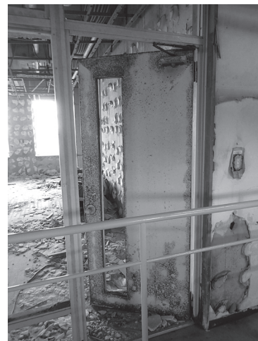
図1 金属製扉の腐食状況(請戸小 2023,7) 筆者撮影
