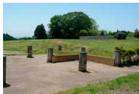
大畑地区 北門表示 柱の腐朽
