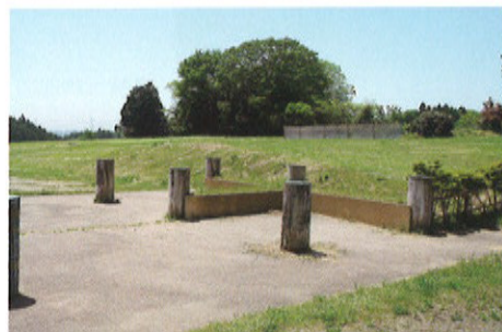
大畑地区 北門表示 柱の腐朽
