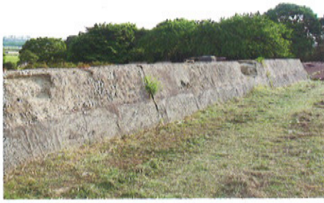
築地塀 表示の劣化 (平成 20 年撮影)
