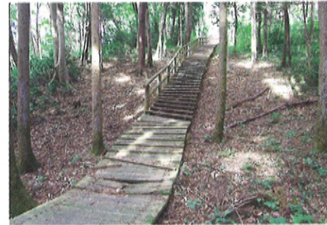
木道の破損状況 (平成19年撮影)
