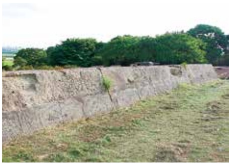
築地塀 表示の劣化 (平成 20 年撮影)
