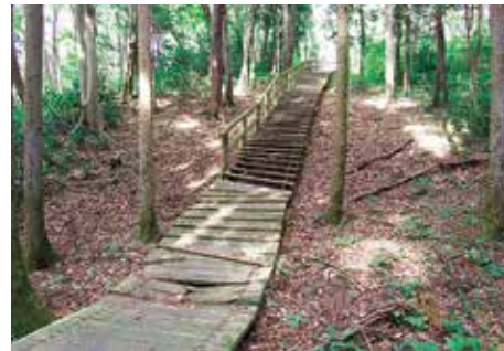
木道の破損状況 (平成19年撮影)
