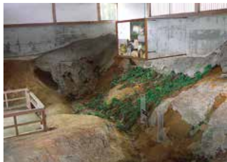
空堀露出展示の劣化 (平成26年撮影)
