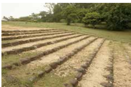
路面舗装の 劣化 (平成26年撮影)
